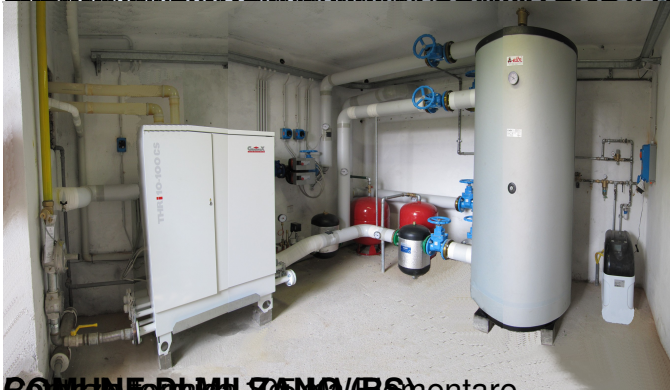
CONTE D'IMPIANTO (BS) centrale termica (BS) e radiatori
