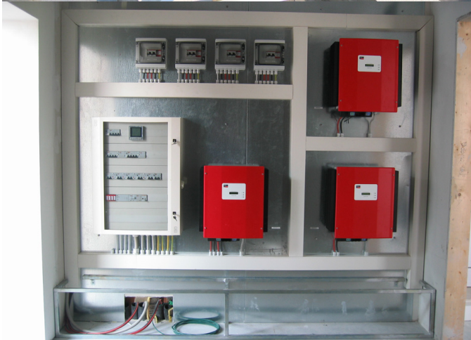
IMPIANTO FOTOVOLTAICO SEMINTEGRATO
